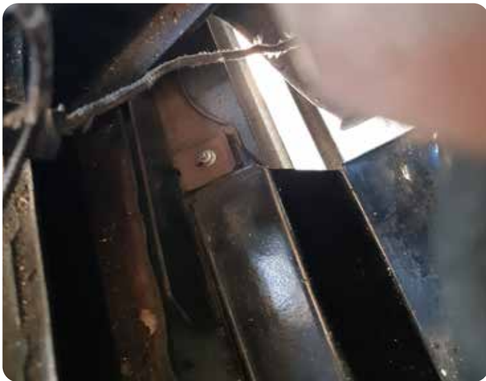
Ontbrekende motorsteun afdekplaat
